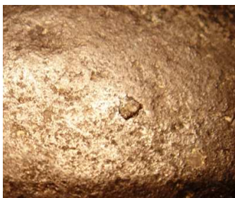
SEGREGACIÓN DEL TRASDÓS
